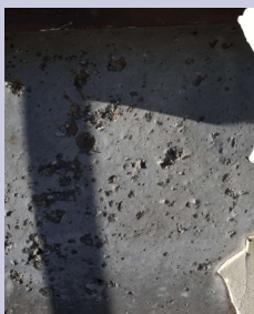
Skader på beton efter udsættelse for en 700 bar brint jetflamme (DTU /USN)
