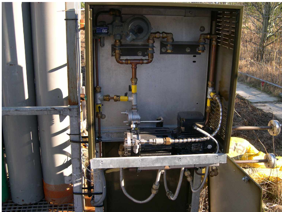
Figur 8 Praktisk realisering af kredsløbet. På billedet mangler dog selve gasmåleren, der netop er afmonteret for efter driftsperiodens afslutning at blive undersøgt og recalibreret hos fabrikanten.
